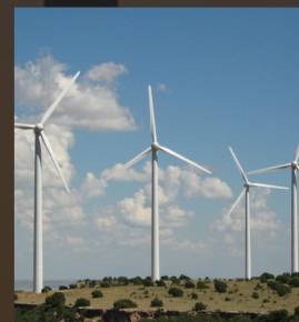
CAPROCK Quay Co., NM 80 MW
